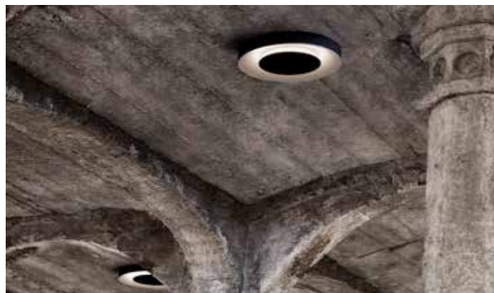
Soffitto, Plafond , Techo - P. 14
